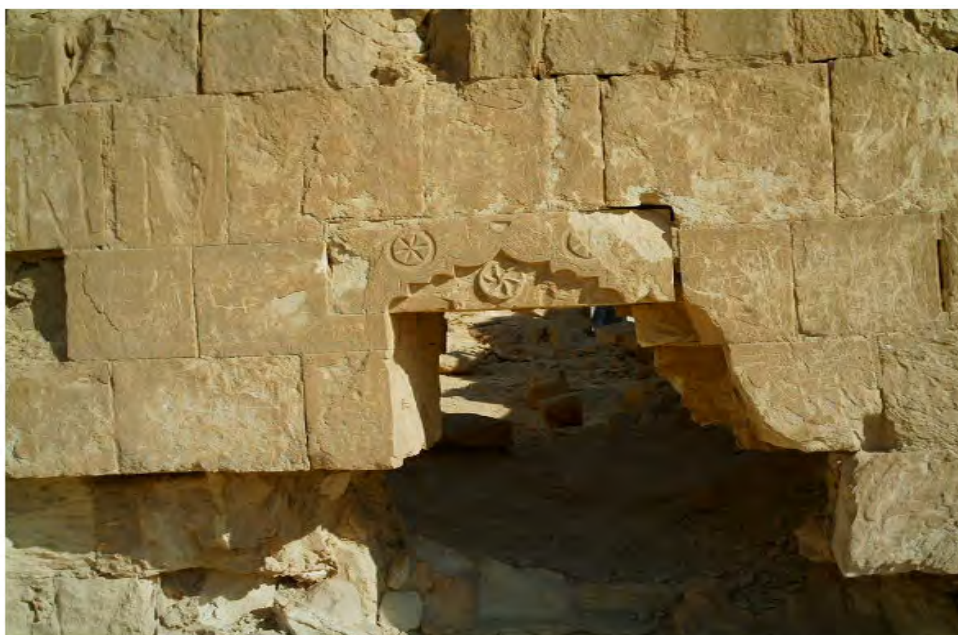
صورة رقم (2) فتحة الصهريج من الخارج أسفل الواجهة الجنوبية الشرقية صوير الباحث
