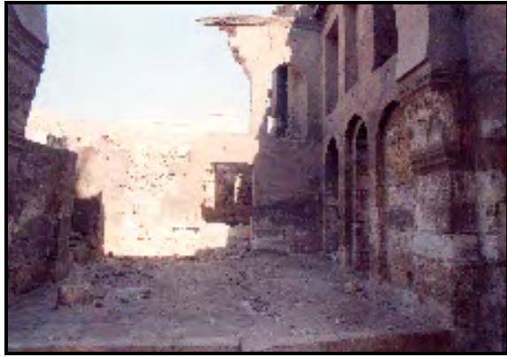
لوحة ١٩ - الإيوان الشمالي الشرقي للرباط قبل الترميم
