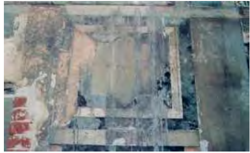
ج- الترميم الخاطئ باستخدام الطوب الأحمر والجبس
