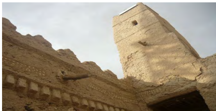
لوحة رقم (٩) ميزاب بجدار المنذنة الجنوبي ويبدو ميزاب سطح المسجد.
