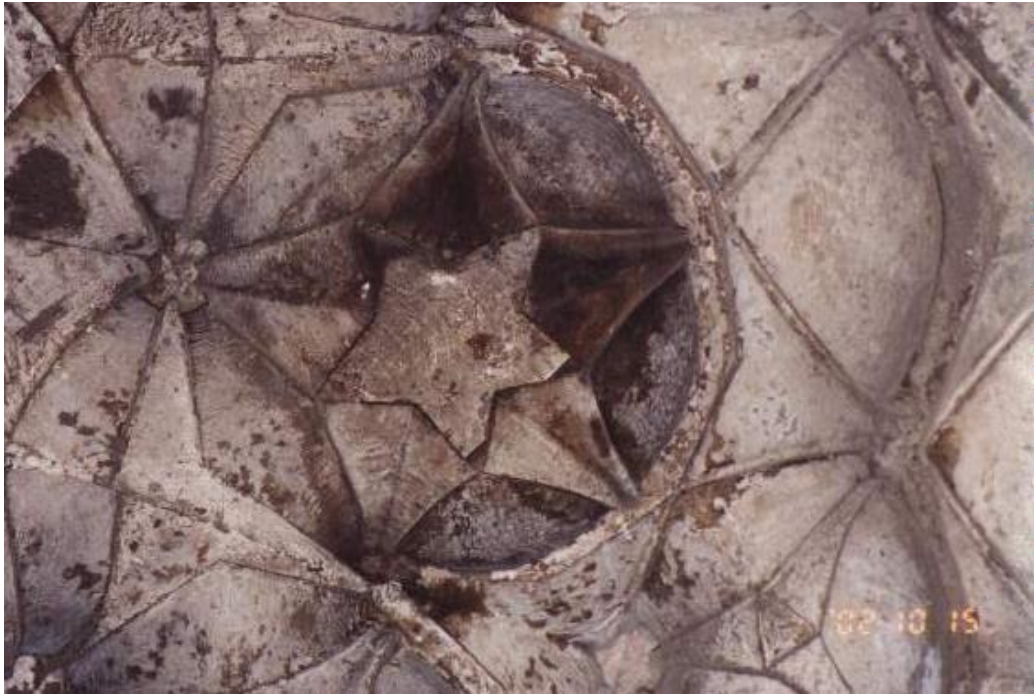
لوحة (١٢) مدرسة سنقر السعدى "بالقاهرة"، تفصيل لمقرنصات طاقيه المدخل السابق، يبين قبواً مروحياً ذا قطب نجمى متأثر بالأقبية المروحية المغربية
