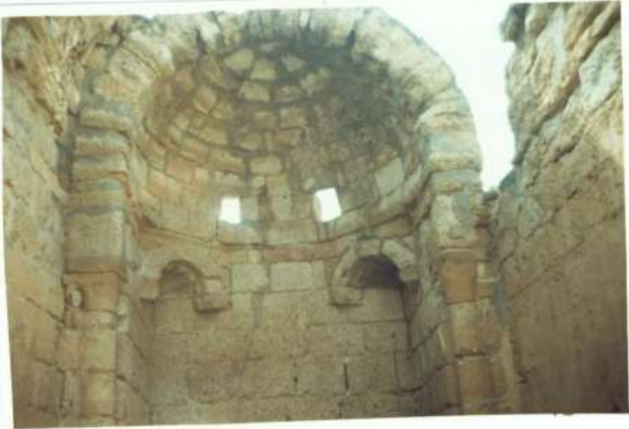
صوره (٥) توضح أسلوب البناء والتشييد لصدر قاعة العرش وحالة قاعة العرش بعد تأثير عوامل البيئة الضارة .
