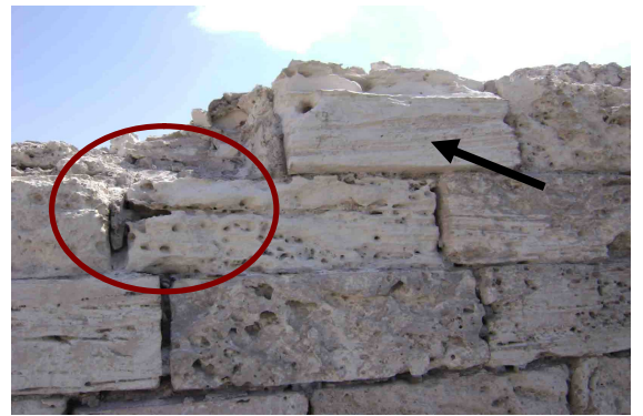
(لوحة رقم ١٣) توضح تآكل الاحجار بفعل تأثير مياه البحر والرياح المحملة بالرمال.
