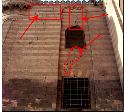
صورة رقم (٩) : مظاهر التلف الانشائية متمثلة في الشروخ الموجودة بأعلي النوافذ وفي أماكن أخرى نتيجة لتأثير التربة علي الواجهة الجنوبية الشرقية بجامع المحمودية.
