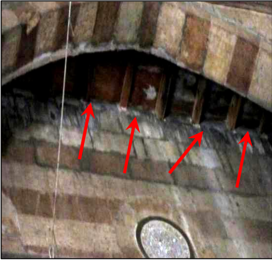
صورة رقم (١٤) : تزهر الأملاح علي سطح الحجر نتيجة لتأثير مياه الأمطار المتسربة نتيجة انفصال السقف عن الجدار (الواجهة الشمالية الغربية - جامع الرفاعي).
