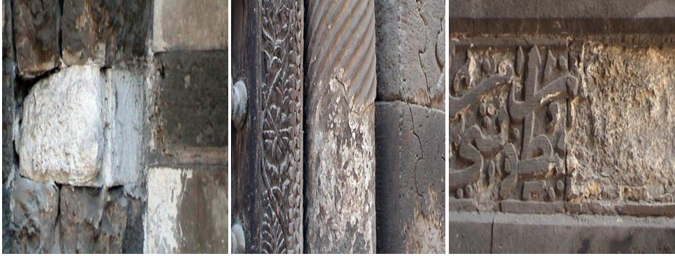
صورة(١،٢،٣) توضح تأثير الرطوبة على تلف مواد البناء في مسجد الطنبغا المراداني وسبيل وكتاب عبد الرحمن كتخدا وسبيل فاطمة خاتون عن: محسن محمد صالح (دكتور): ٢٠٠٥م.
