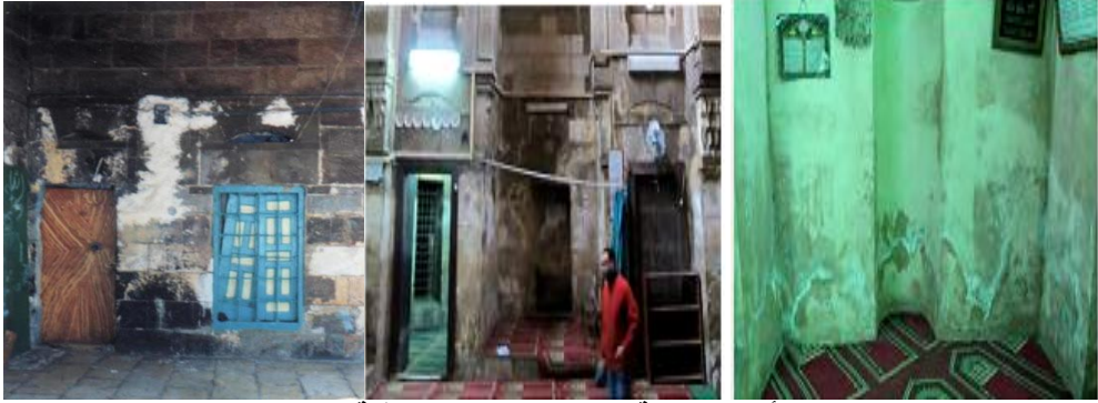
صورة (٤، ٥، ٦) توضح تأثير الرطوبة داخل مشهد السيدة رقية - داخل مسجد تغرى بردى - عن: اليونسكو: مركز التراث العالمي، ٢٠١٤م. داخل التكية السليمانية: الباحث
